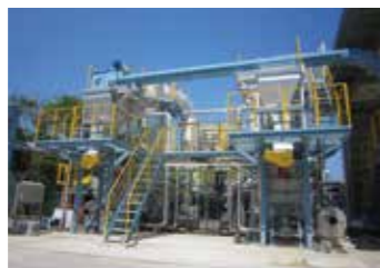
バイオマスボイラ設備
