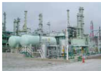
アンモニア設備
