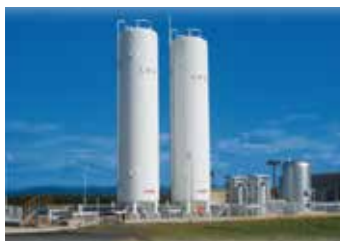
LNGサテライト設備
